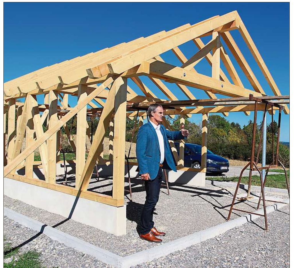
Auf dem Killberg entsteht ein schmales Häuschen. Bürgermeister Markus Huber hofft, dass es noch im Herbst fertiggestellt werden kann. Foto: Steinmetz
